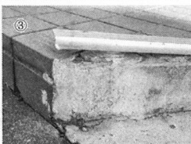
③ 床の滑り止めがはがれた状態。転んだ拍子に怪我の恐れがあります。
